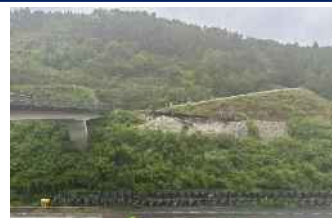
【変状発見時ののり面全景】
